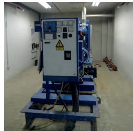
68. Centro de transformación
