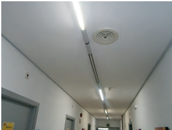
Iluminación pasillo de despachos
